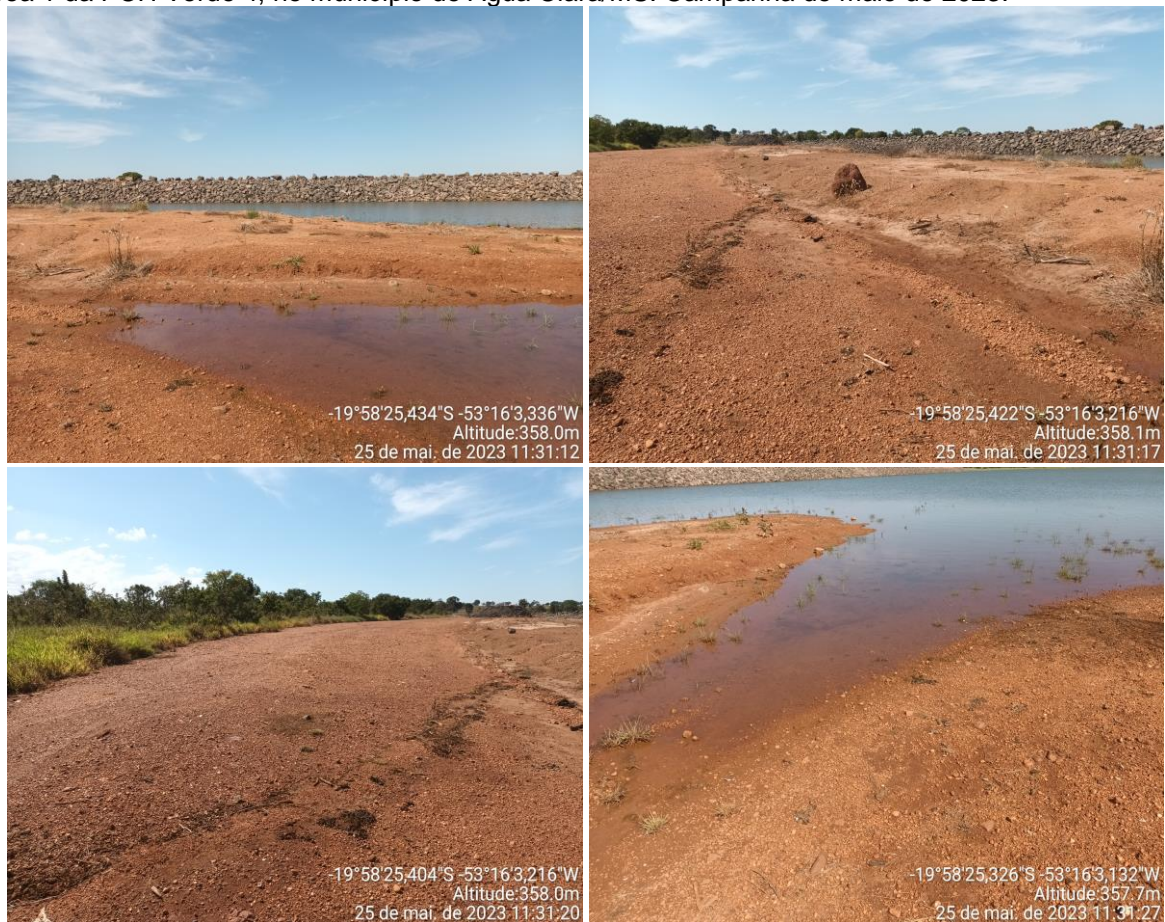
Figura 3. Ponto 1: Marcas de erosão em sulcos na margem, ausência de cascalho ou vegetação, área 1 da PCH Verde 4, no município de Água Clara/MS. Campanha de maio de 2023.
